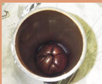
Deckenverschluss nach Brand
